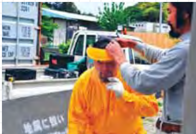
ในการตัดคอนกรีต อาจมีเศษผงหรือชิ้นส่วนกระเด็นเข้าหน้าได้ จึงควรสวมหน้ากาก หรือแว่นตาป้องกัน เพื่อความปลอดภัย
