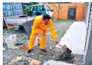
ใช้พลั่วตักปูนเทลงไป แต่ควรให้ปูนกลบให้ลึกและทั่วถึงใต้ตะแกรงเหล็ก โดยไม่ให้มีช่องว่าง
