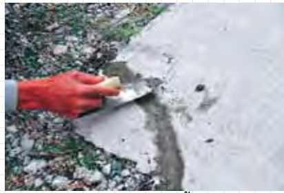
ใช้เกรียงปาดปูนส่วนเกินจากพื้นผิวคอนกรีตให้เรียบเสมอกัน
